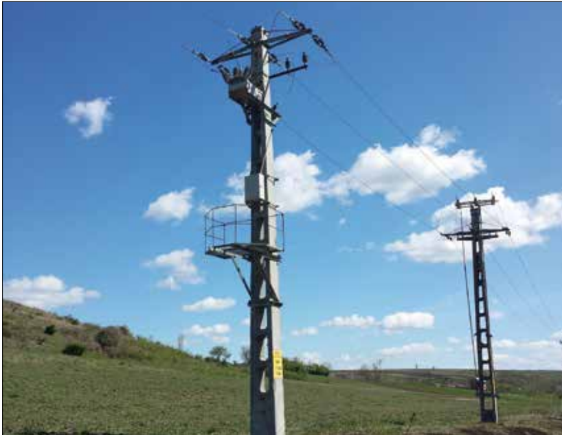
Bild 2. Die App Sicam Localizer liefert für Verteilnetze mit Freileitungen klar und übersichtlich detaillierte Informationen über den jeweiligen Zustand einzelner Netzsegmente
