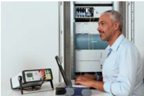
Mise en service du SWT 3000
