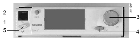
Appareil de service et d'exploitation sur le régulateur
